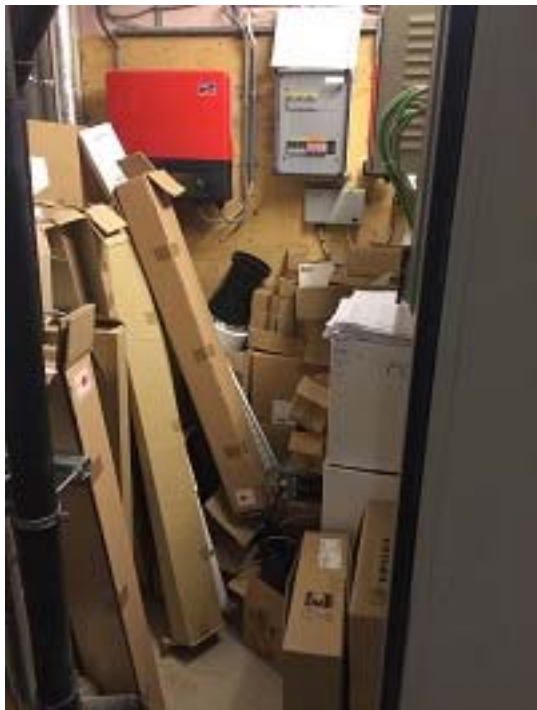
Brandgevaarlijk – in spanningskast
