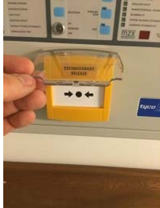
Gasblusinstallatie in openbaar gebied
