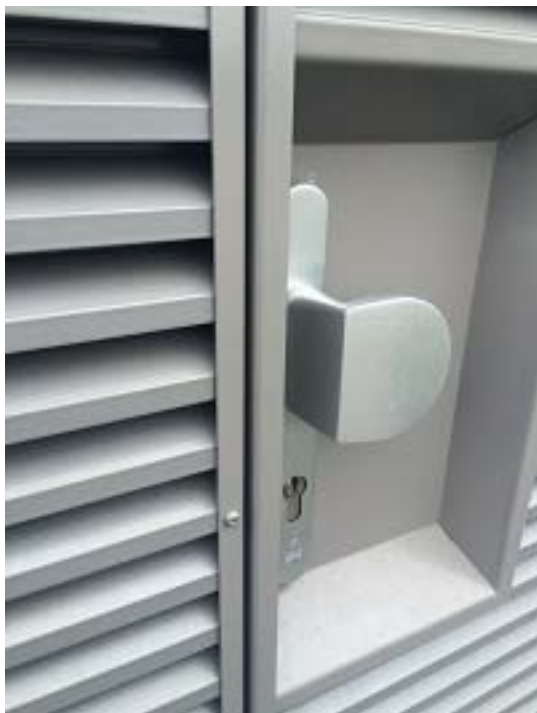
Deurdranger trekt buitendeur niet goed dicht
